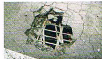
床版の疲労による部分抜け落ち
