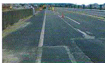
橋梁の補修跡(再劣化)
