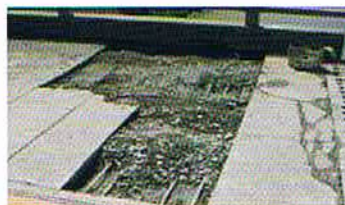
凍害による床版上面の損傷
